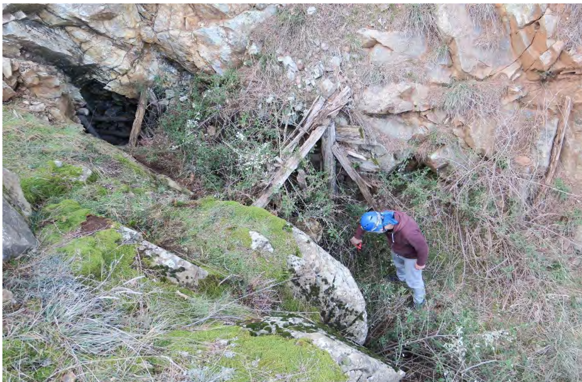
Φωτογραφία 37. Η περιοχή της εισόδου του ορυχείου του Τσούτουρου. Διακρίνονται τα τσακισμένα ξύλα της υποστήλωσης (κέντρο) και μία από τις δύο νέες εισόδους (πάνω αριστερά).
